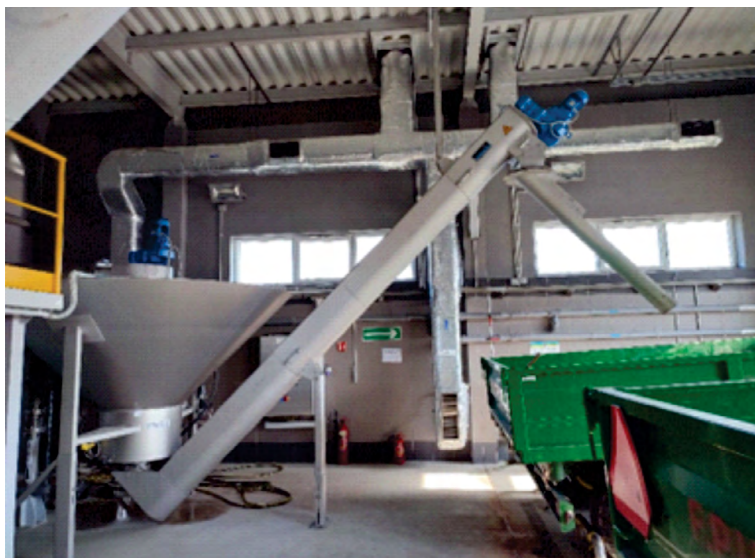
Fig. 1. Sand separator at the Kraków–Płaszów WWTP
